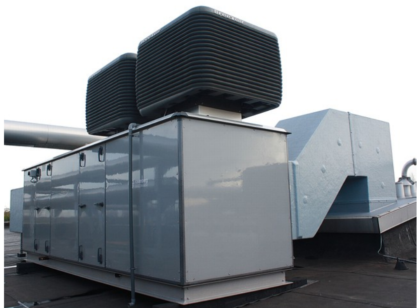
De installatie bevat 25 adiabaten van Breezair
